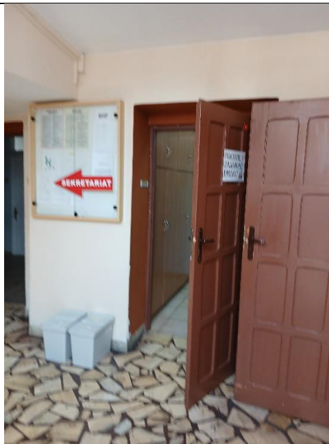
drzwi wewnętrzne do wymiany na nowe + widok posadzki kamiennej
